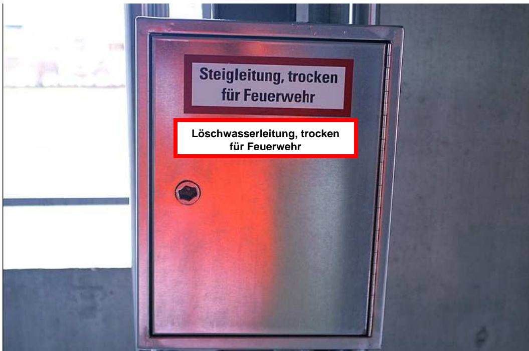
Entnahmeeinrichtung DIN 14461-2 für Löschwasseranlage (Steigleitung) „trocken“ Zukünftige Beschriftung: „Löschwasserleitung, trocken für Feuerwehr“ (Bildquelle LFS Baden-Württemberg)
