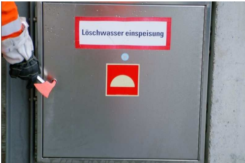
Einspeiseeinrichtung DIN 14461-2 für Löschanlage (Steigleitung) „trocken“ (Bildquelle LFS Baden-Württemberg)
